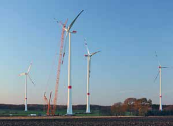
Windkraft XXL: Die Repower-Anlagen in Wittgeeste sind mit 180 Metern Gesamthöhe und 104 Metern Rotordurchmesser derzeit die größten im Landkreis.
